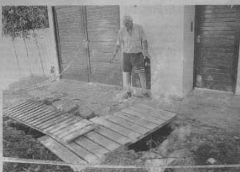
Hace un mes que operarios de Absa hicieron un pozo de cuatro metros de profundidad en el N° 1916 para reparar la red cloacal y al no encontrar el caño, dejaron el agujero a cielo abierto. Los vecinos denunciaron las incomodidades que eso genera y el peligro que implica para los chicos de la cuadra.
