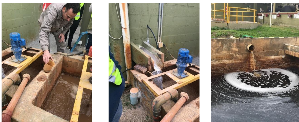
Fotos 17, 18 y 19. Tratamiento de lixiviados
