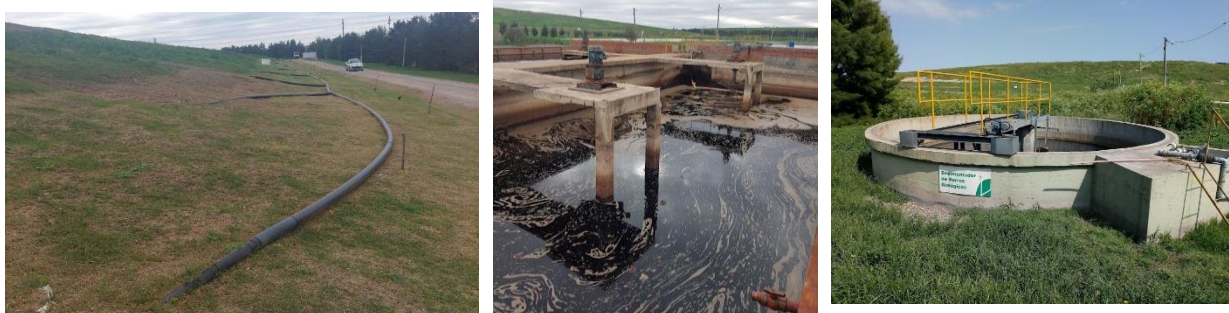
Foto 12. Sistema de cañerías; Fotos 13 y 14. Tratamiento de Lixiviados
