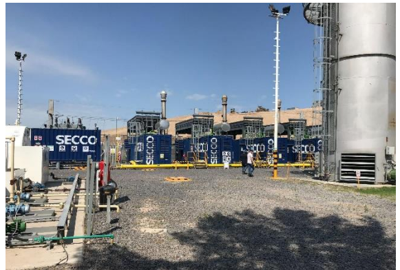
Foto 22. Planta de generación eléctrica
