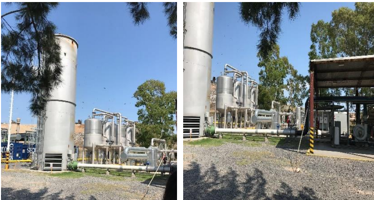
Fotos 20, 21. Planta de biogás
